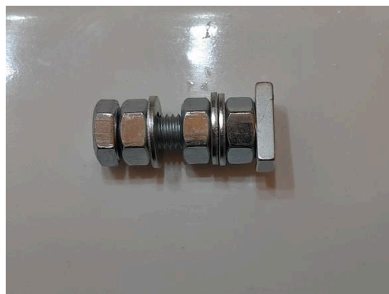
Voici le dispositif qui maintient la trappe de visite en place
